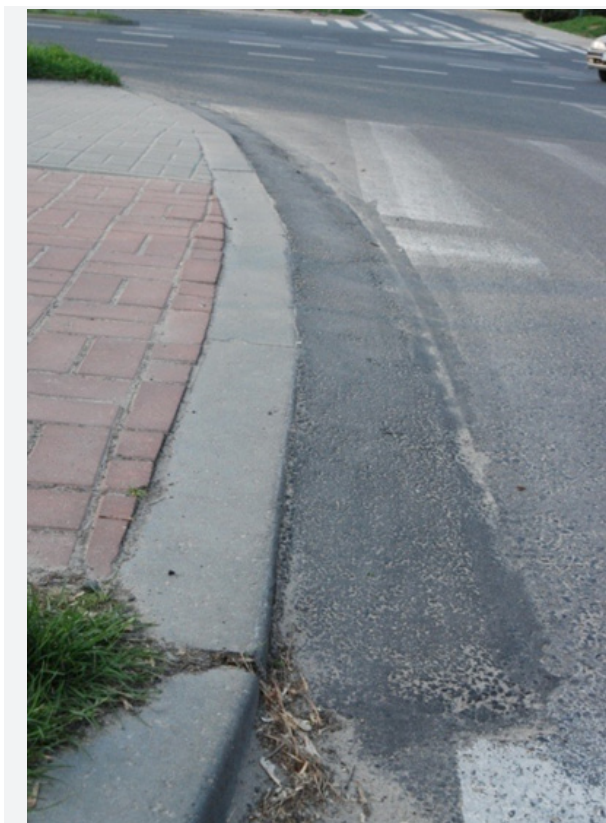
ZDJĘCIE 74. Wylewka z masy bitumicznej ułatwiający podjazd na krawężnik - rozwiązanie tymczasowe.
