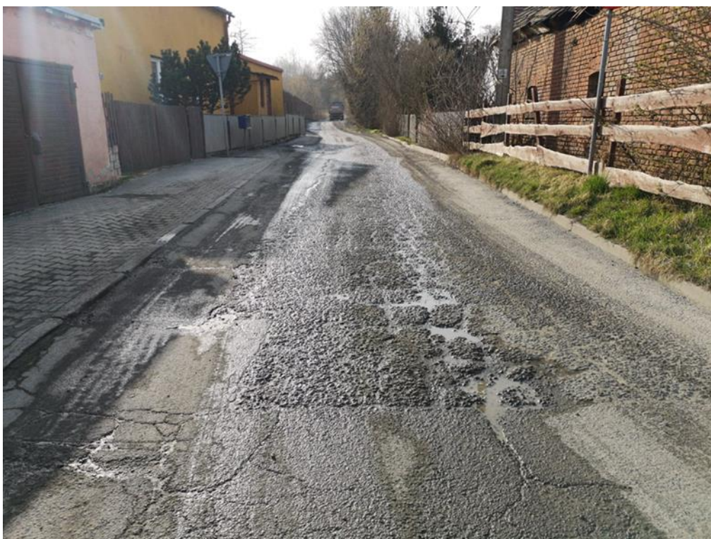
Fot. 11. Zniszczona nawierzchnia drogi wykorzystywanej do samochodowego transportu kruszyw w gminie Leśna (fot. N. Derdacka, 2020)
