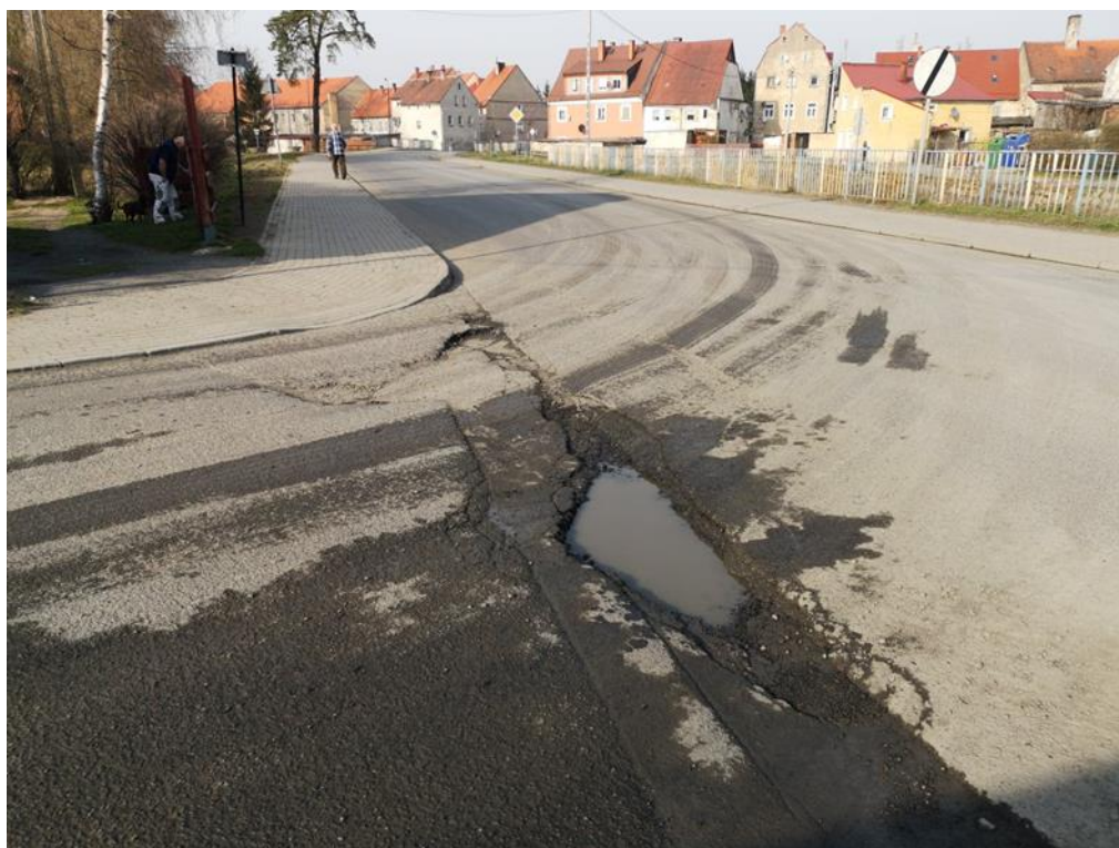
Fot. 12. Zniszczona nawierzchnia drogi wykorzystywanej do samochodowego transportu kruszyw w gminie Leśna (fot. N. Derdacka, 2020)
