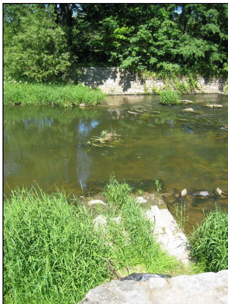
km ok. 39,8 – pozostałości betonowego progu przy brzegach rzeki
