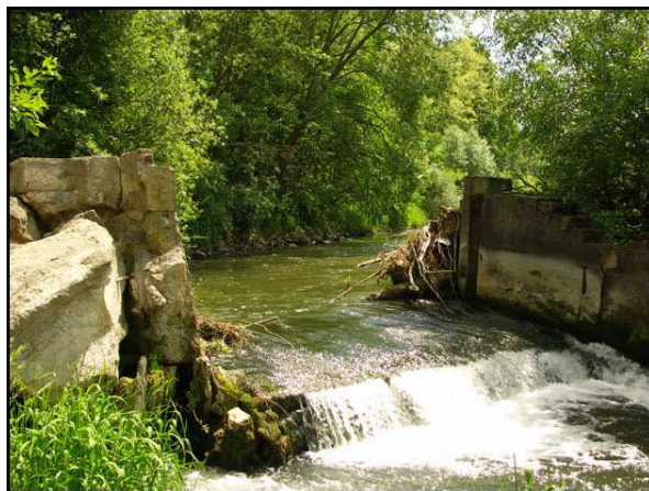
km 36,025 – zniszczony jaz w Kliczkowie
