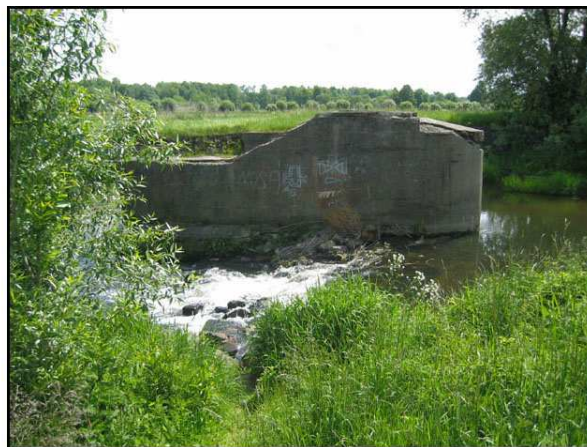
km 83,220 – zniszczony stopień w Księginkach
