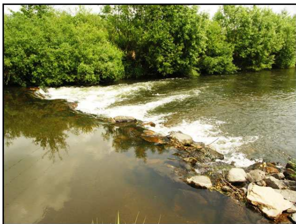
km 72,1 – zniszczony próg regulacyjny w Nawojowie Śląskim
