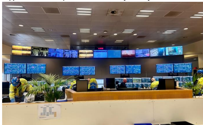
Zdjęcie 45. Instalacja AEB Amsterdam [2024 r.]
